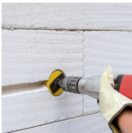
Otvory pro krabice vypínačů se jednoduše navrtají pomocí speciálního vrtáku. Vrtáčkou bez příklepu a obyčejným vrtákem na železo vyvrtáme libovolný otvor.
